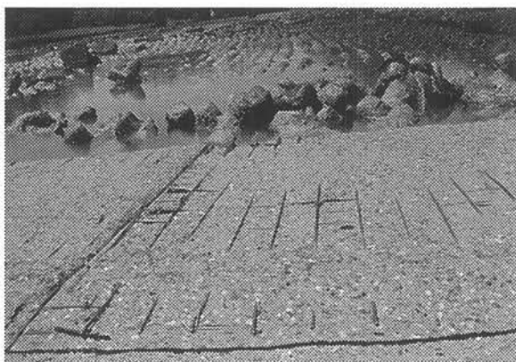
(写真-1) 某頭首工エプロン部の摩耗状況
